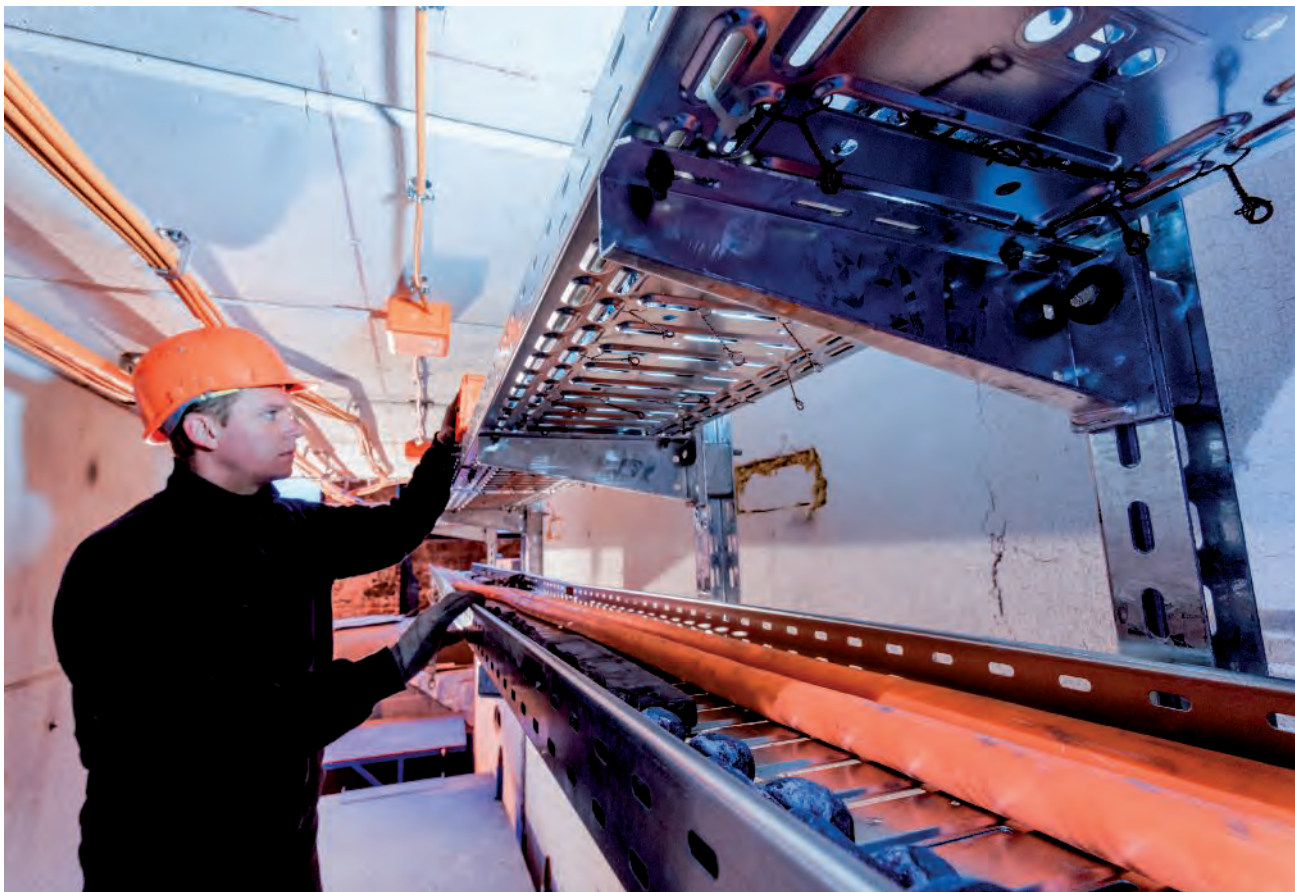
Estructura de prueba de una instalación de cables de mantenimiento de función
