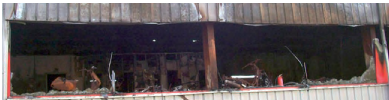
Daños de incendio por gases corrosivos
