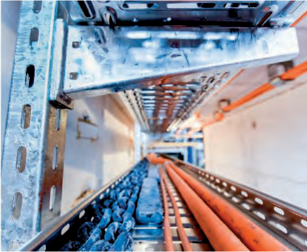
Cable de seguridad frente...
