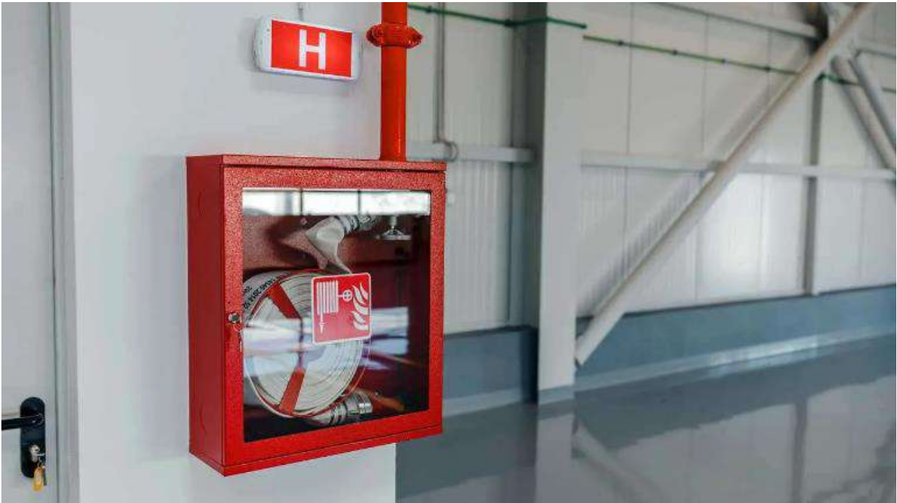
Montantes y Mangueras Contra Incendio
