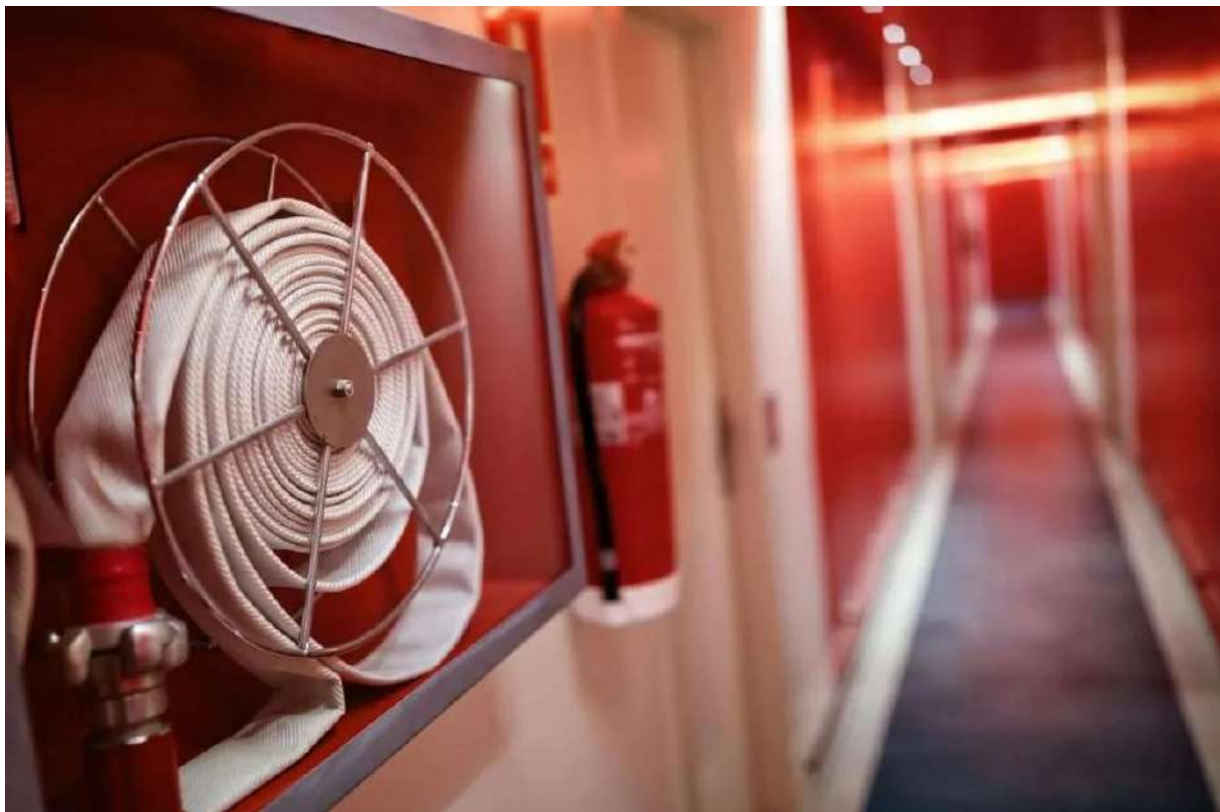
Gabinete de Manguera contra Incendio en un Corredor
