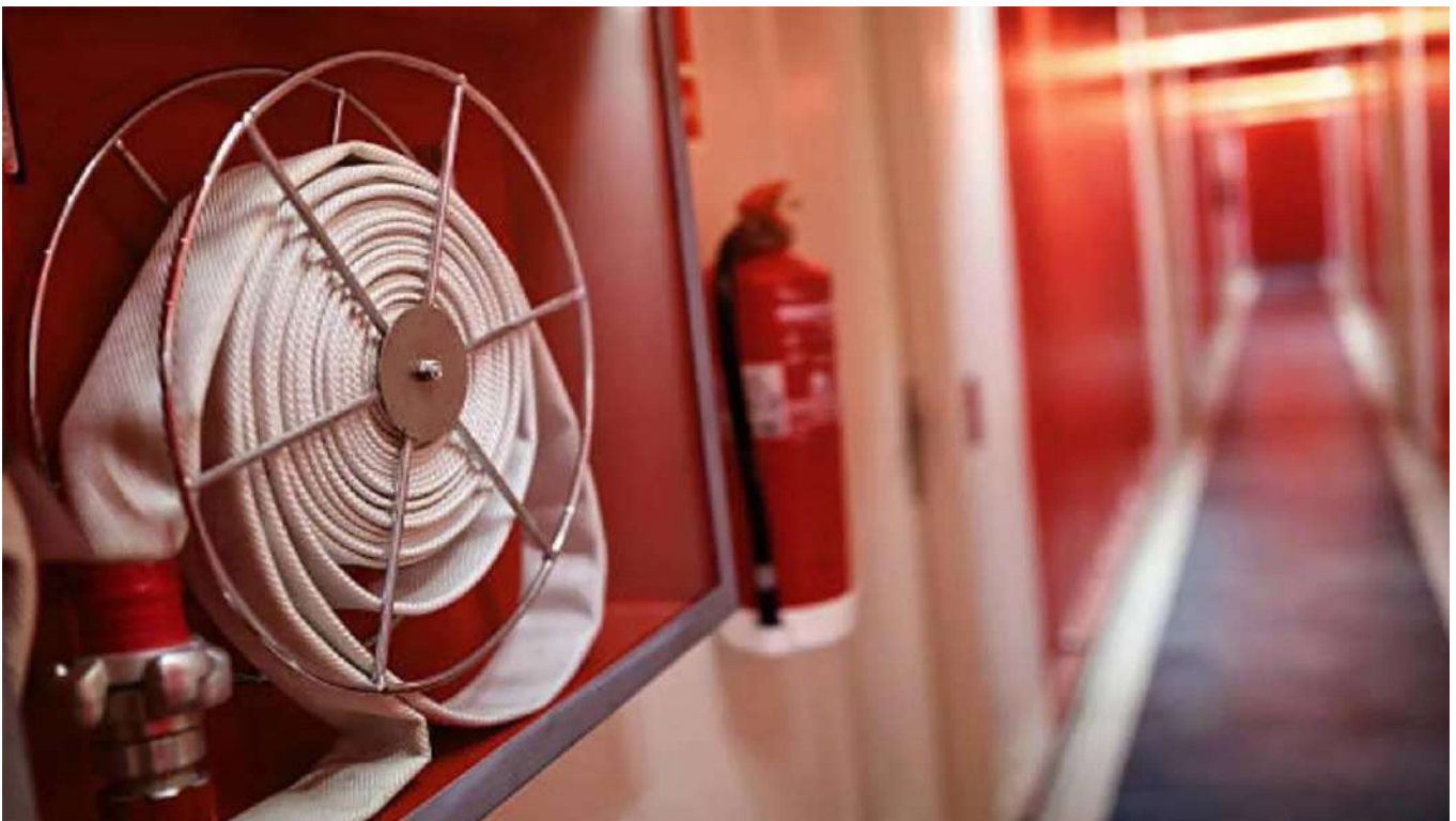
Carretes de mangueras contra incendio
