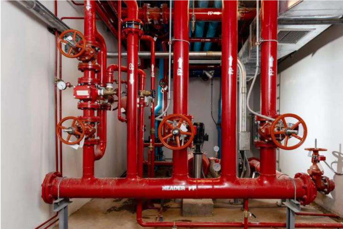
Montantes en un sistema de Extinción de Incendio
