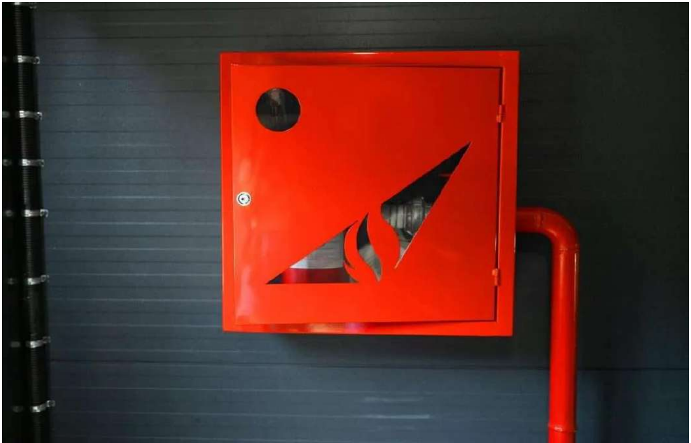
Mangueras contra incendio en la pared de un edificio
