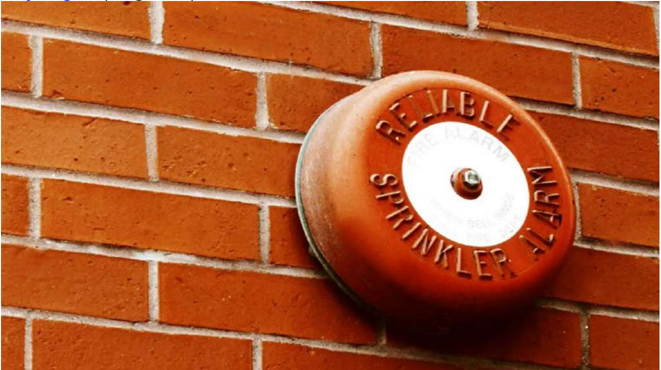
Campanas de alarma en montantes de incendios
