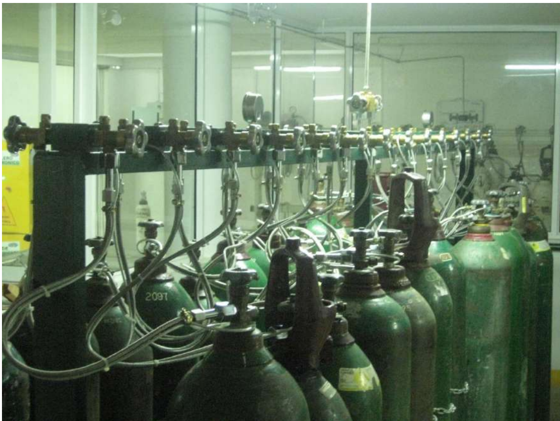
- Fig. 2.5.1.4 Rampa de carga de oxígeno de un hospital.
